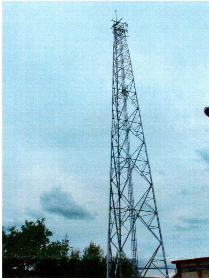
Zał. nr 1: Widok ogólny instalacji radiokomunikacyjnej.
